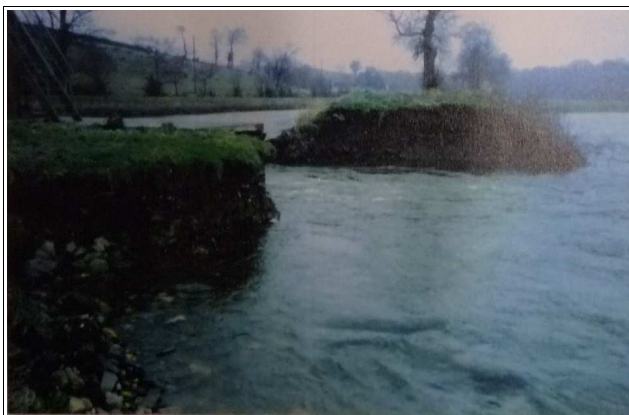
BRÈCHES IMPORTANTES Bief de Kergoutois (Carhaix)
